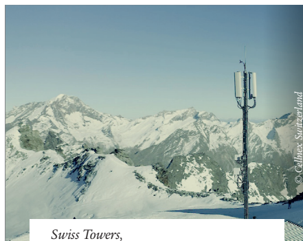
Swiss Towers, Mobilfunkmasten, Schweiz
