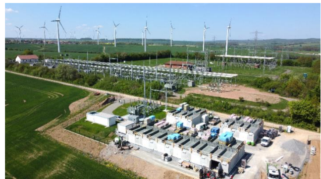
68-MWh-Elektrobatterieprojekt in Eisenach, Deutschland.
